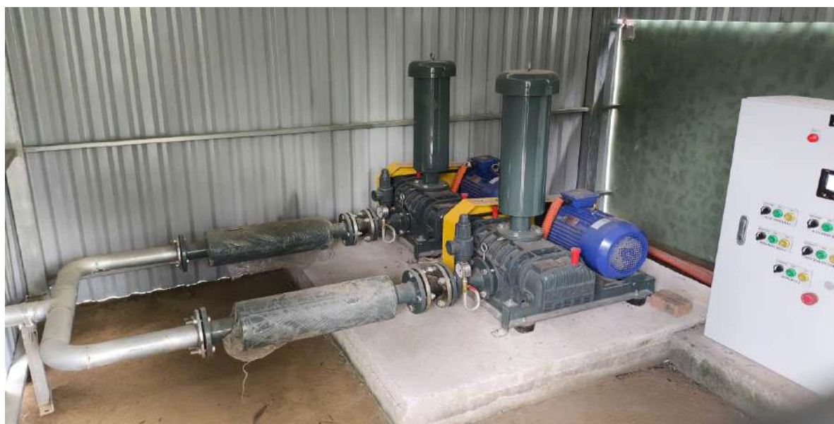
Máy thổi khí và tủ điện
